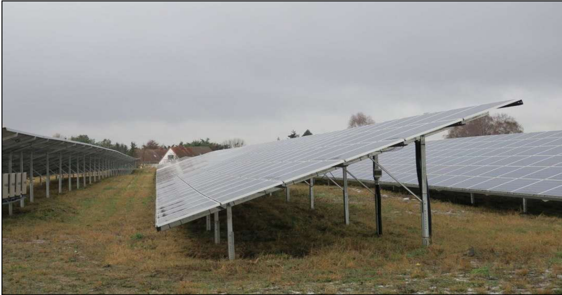
Abb. 5 Beispiel einer vergleichbaren PV-FFA (mit geringeren Modulreihenabständen)
